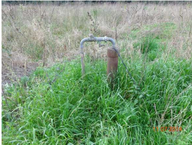
Figura 22 – Poço tubular Contini
