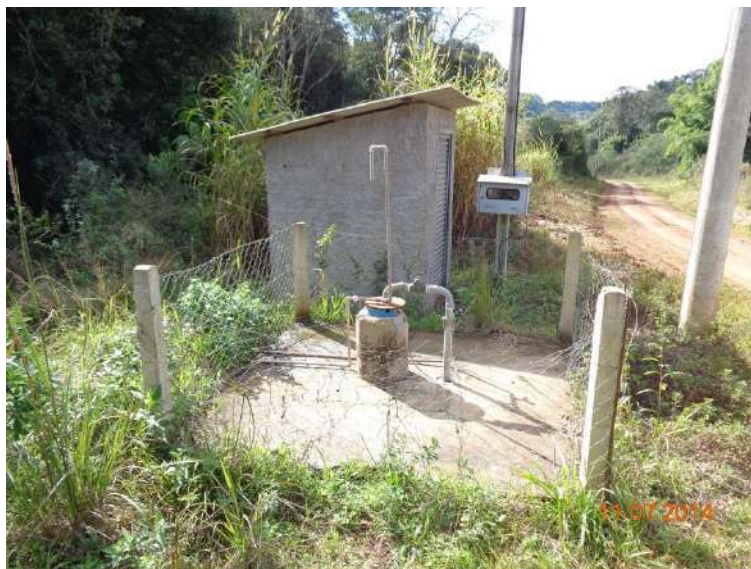
Figura 19 - Poço tubular Colette
