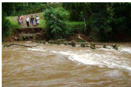
Figura 37 – Destruição de ponte causada devido a evento extremo (1)
