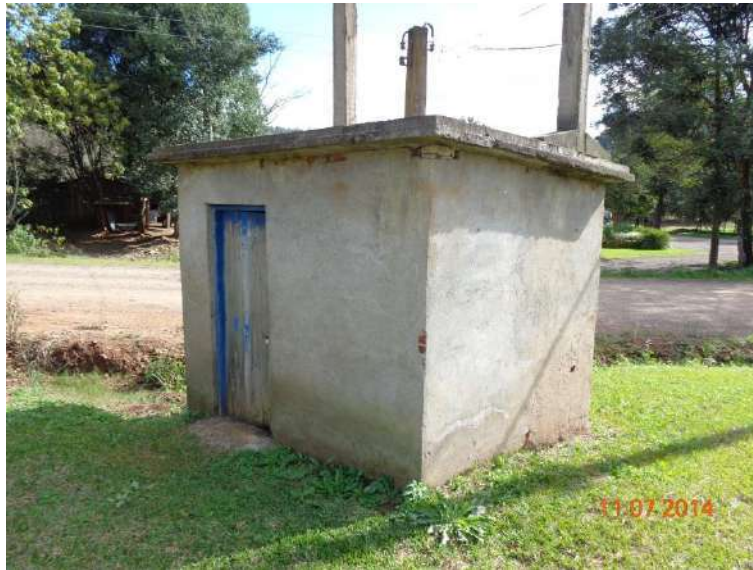
Figura 20 - Poço tubular Paquetá
