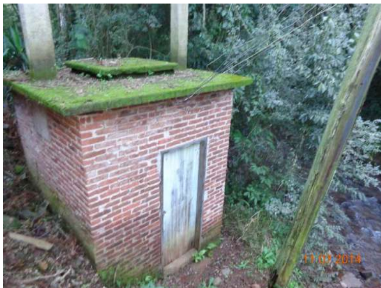
Figura 23 – Poço tubular Garagem
