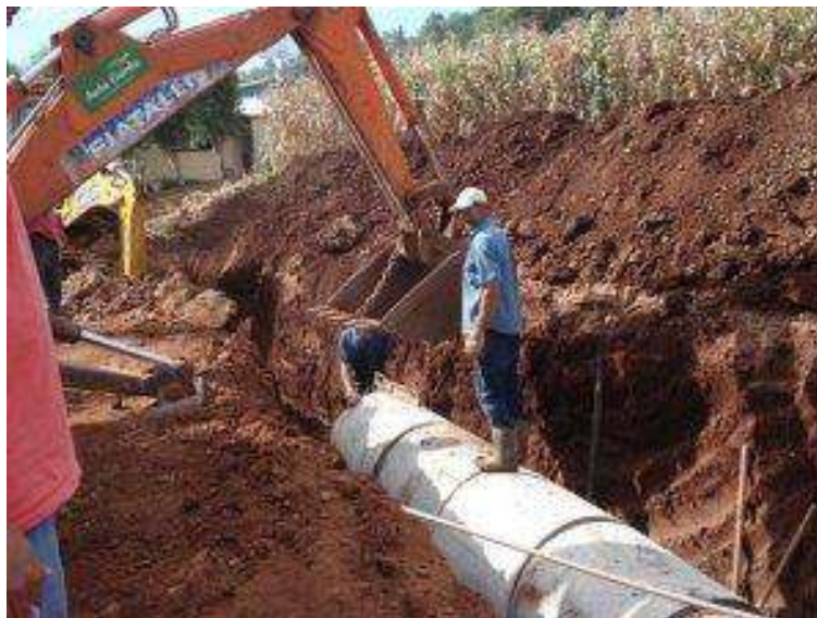
Figura 28 – Implantação de tubulação de concreto em loteamento do município, visando o escoamento das águas pluviais.
