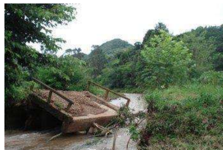
Figura 36 - Destruição de ponte causada devido a evento extremo (2)
