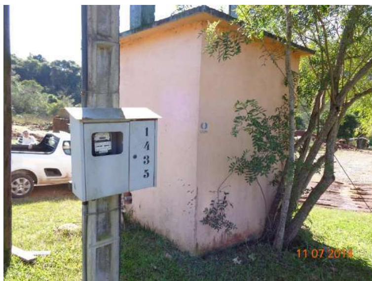
Figura 24 – Poço tubular Borghetto
