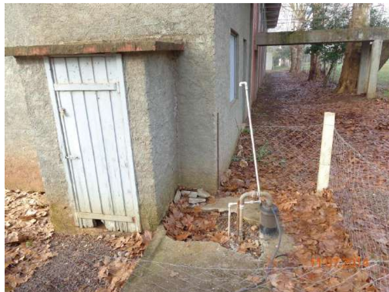
Figura 26 – Poço tubular Cabral
